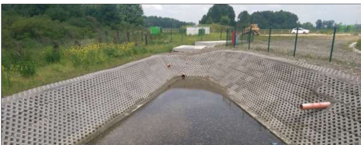
Slika 2.2.-4. Pogled na izvedeni bazen za oborinsku vodu, južni dio odlagališta, u pozadini je vidljiv i elektroagregat
